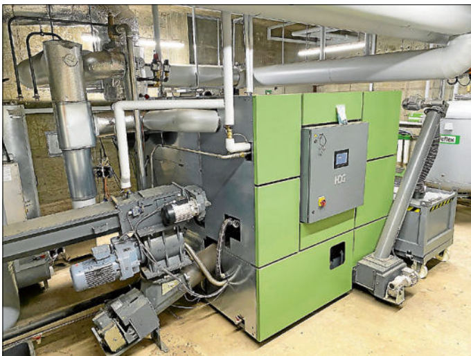
die neue Hackschnitzelheizung
