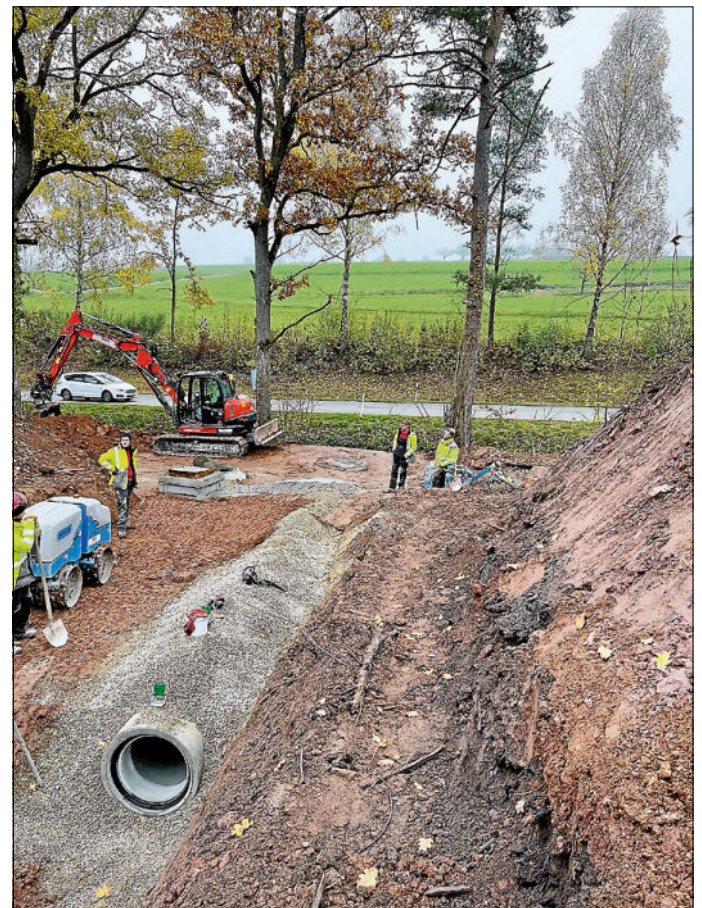
Regenrückhaltebecken am Dürrbach in Liebelsberg Fotos: Stadt Neubulach
